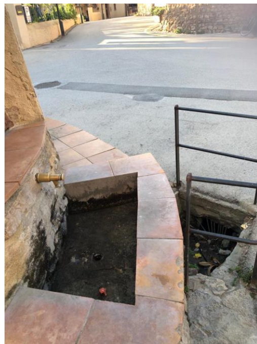
Imatge 23: Font i canalitzacions de desguàs del pou
