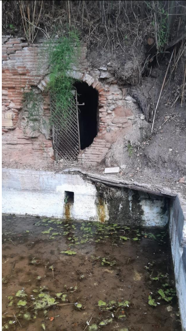
Imatge 32: La mina i entrada d'aigua
