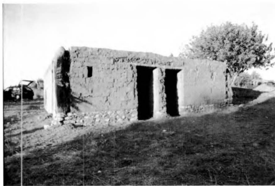
FIGURA 18: Desperfectes a la paret est com a conseqüència de l'acció erosiva de l'aigua de pluja (Laboratori d'Arqueologia Experimental del Vendrell).
