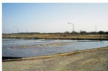
Depuradora de La Sènia Població servida: 8.750 habitants (h-e). Tractament biològic.
