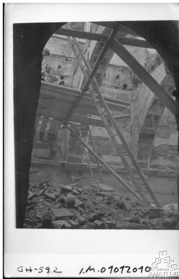
Fig. 4: Fotografia de les runes de la sala capitular després de l'incendi de l'agost de 1936, © Arxiu Mas
