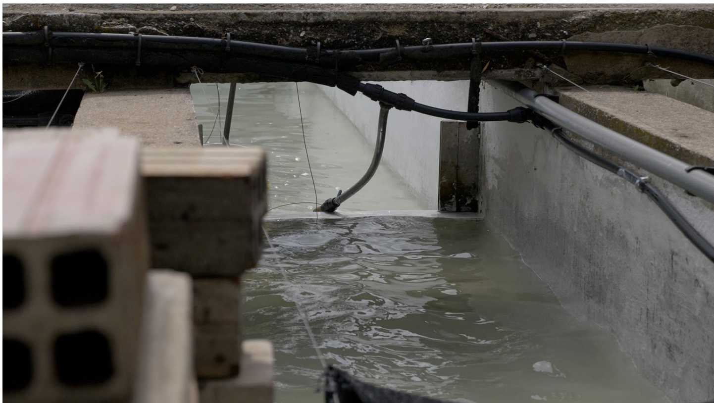
Figura 79. Recirculació de l'aigua un cop acabat el sanejament de les instal·lacions. A la intempèrie , Job Ramos, (2021). [Fotograma]. Autor de la imatge: Job Ramos, 2021.
