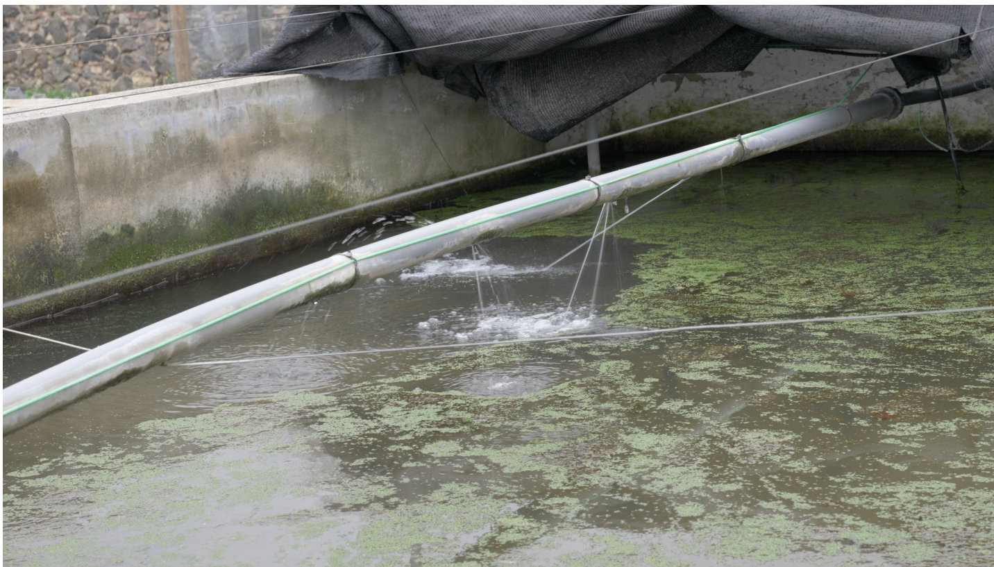
Figura 31. Tub de PVC de recirculació on es poden observar fuites. Monitoratge audiovisual. [Fotograma]. Autor de la imatge: Job Ramos, 2020.
