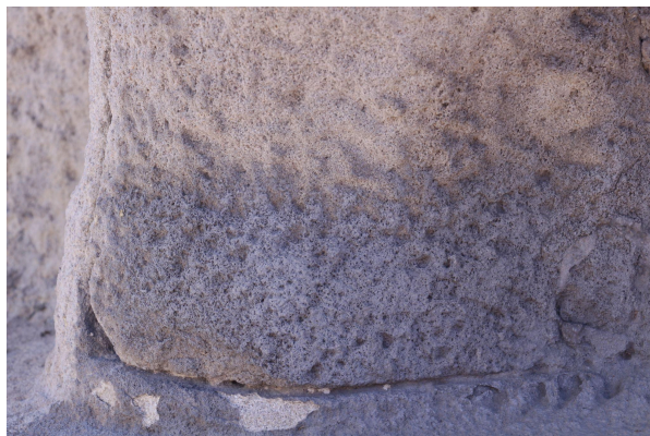
Fig. 37. El forjador , Josep Llimona. Pla detall, revers. Observació de crosta negra a la zona inferior. Fotografia pròpia, febrer de 2025.
