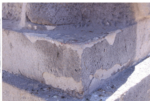
Fig. 36. El forjador , Josep Llimona. Pla mig llarg, revers. Observació de crostes negres i laminació a la zona del pedestal. Fotografia pròpia, febrer de 2025.
