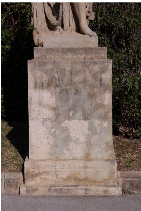
Fig. 81. Figura femenina , d'Eusebi Arnau. Pla mig, anvers. S'observen fractures i irregularitats al pedestal. Fotografia pròpia, febrer de 2025.
