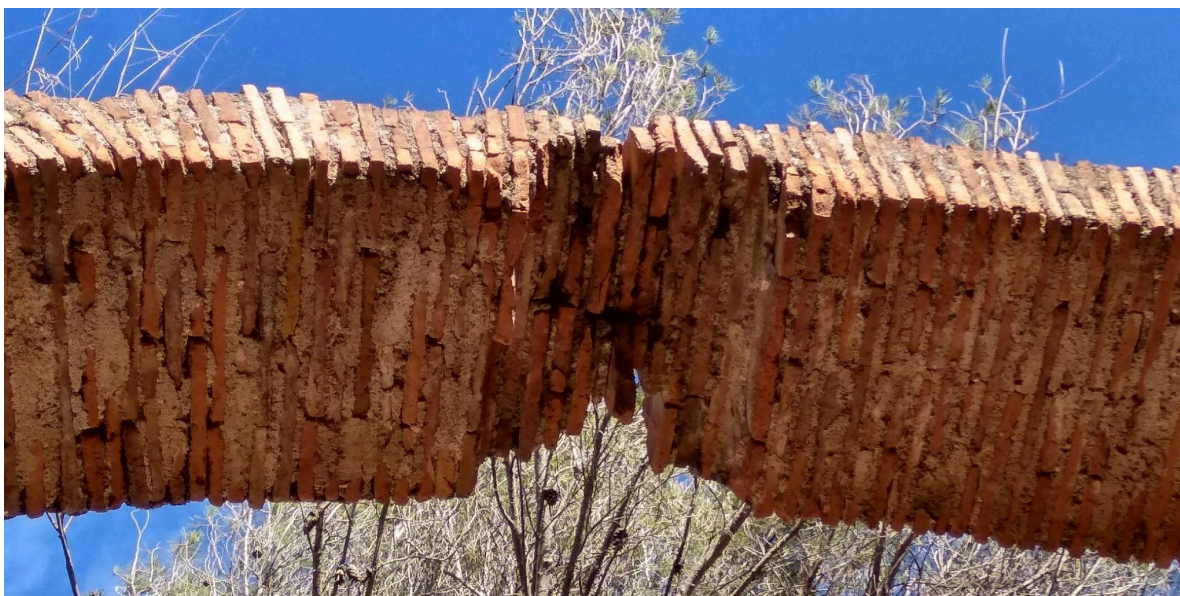
Detall de la part central de l'arc de maons que suportava la coberta, a punt de trencar-se. 2022.
