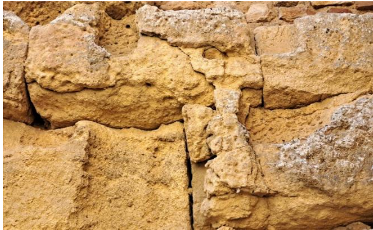
Figura 5. Fotografia on s'observen fractures que podrien derivar en grans pèrdues de material, així com dejeccions d'aus.
