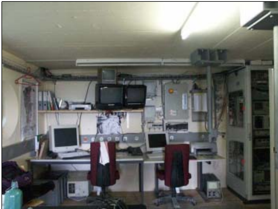
Figura 4-14. Centro de control de los instrumentos. Fotografía realizada por Emma Suriñach Cornet
