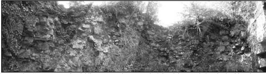
Fig. 62- Parte superior del lienzo norte de A, con el núcleo del muro al aire, desde el interior.
