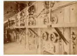
Túnel de Argentera. Cuarto de calderas de las máquinas del pozo nº 4
