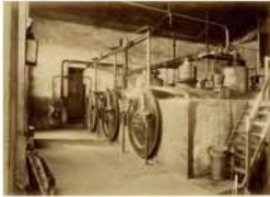
Cámara de generadores de vapor para la obtención de la fuerza hidráulica
