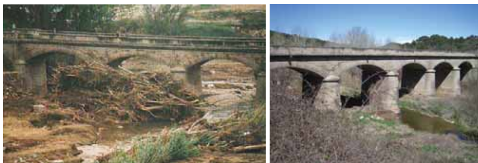
Fotos n. 45.46 Pont sobre la carretera de Monistrol a Calders (B-124), sobre la Golarda en el lloc immediat abans d'abocar les aigües al Calders. A la foto de l'esquerra es veu com va quedar després de la riuada del 10.10.94.
