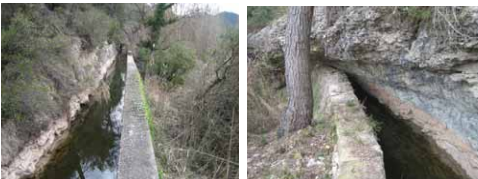
Fotos n. III.63.64 Aspectes del canal de Jorba en aquesta zona entre la presa de Bellveí i la central a Manganell
