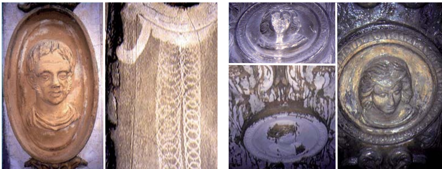
Figura 2. Sistemas agresivos de limpieza. Medallón del carrer d'en Quintana, 5 —chorro de arena— y detalle de plafón del carrer Ferran, 30 —instrumentos abrasivos— (izquierda). Limpieza con AB-57. Imágenes del proceso seguido en el carrer d'Escudellers, 31 y carrer del Vidre, 7 (derecha).
