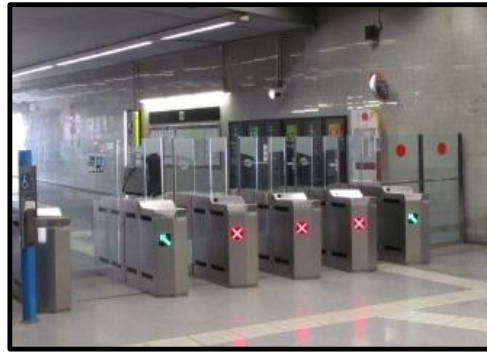
Figura 8. Puertas de acceso automáticas en Trinitat Nova
