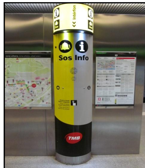
Figura 9. Sistema de información y socorro instalado en el andén de Roquetes .
