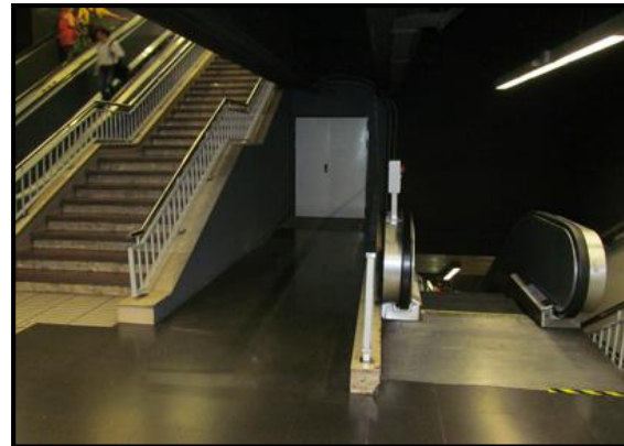
Figura 10.2. Ejemplo de espacio sin instalación de barreras, en la zona de transición de la estación de Penitents . Además, este espacio en concreto se trata de un escondite con falta de iluminación.
