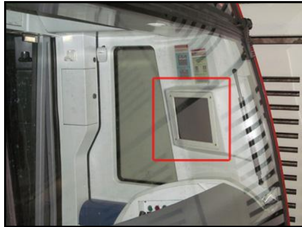
Figura 12 Pantalla CCTV en la cabina del conductor del tren S/5000.
