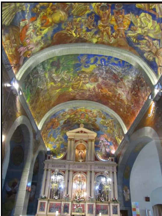
Imatge 117. Sostre de la nau central de l'església de Bellvei. Imatge inèdita fotografiada per Toni Sangrà (2012).
