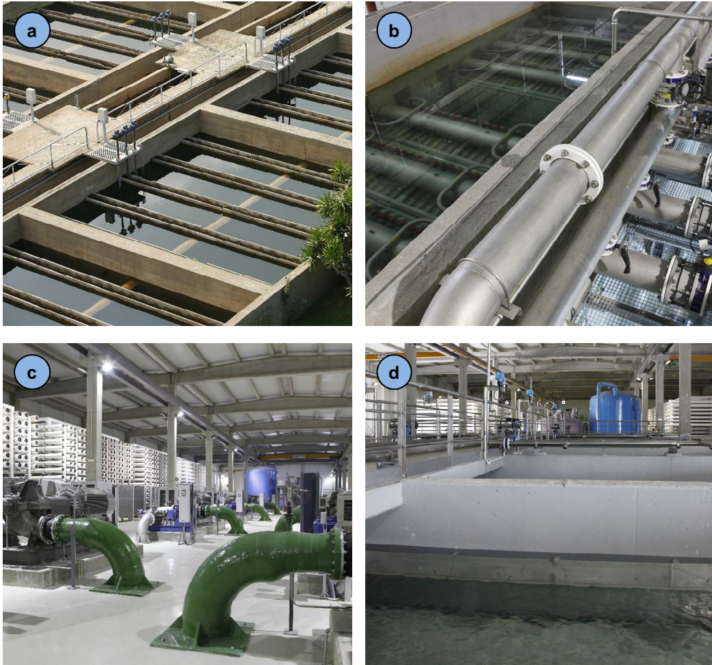
Figura 24. Fotografies de diverses etapes de la potabilitzadora del Llobregat: a) sedimentació, b) ultrafiltració, c) osmosi inversa , i d) remineralització.
