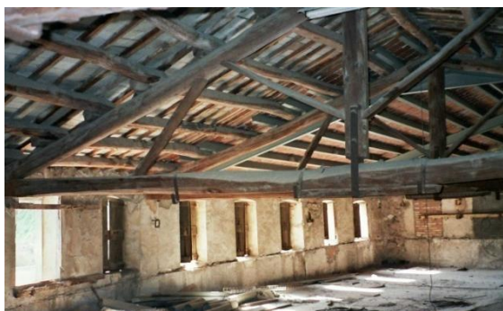
Vestigis de l'antiga construcció al pis superior, amb les ventanes i el bigam de la coberta (2004)
