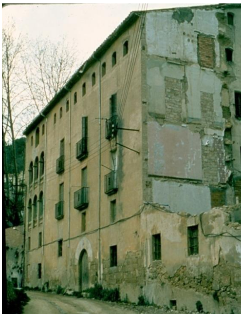
Façana i habitatge principal, amb part del sector productiu enrunat (anys 80).
