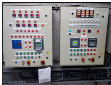
Fig. 4 Panels elèctrics UV
